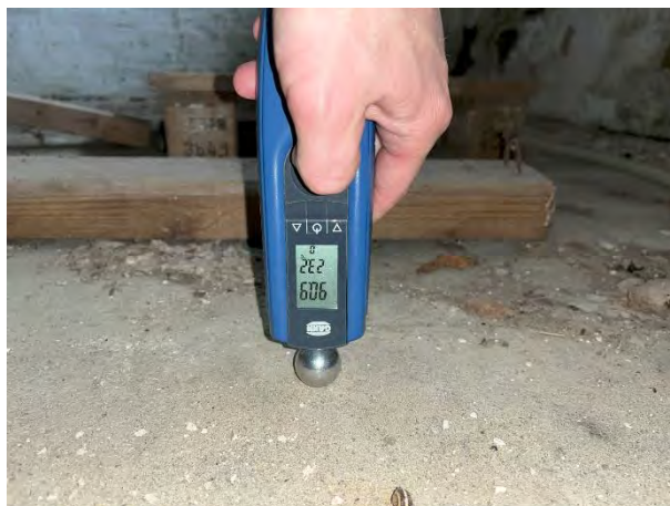
Fugtmåling af betongulv i kælder
