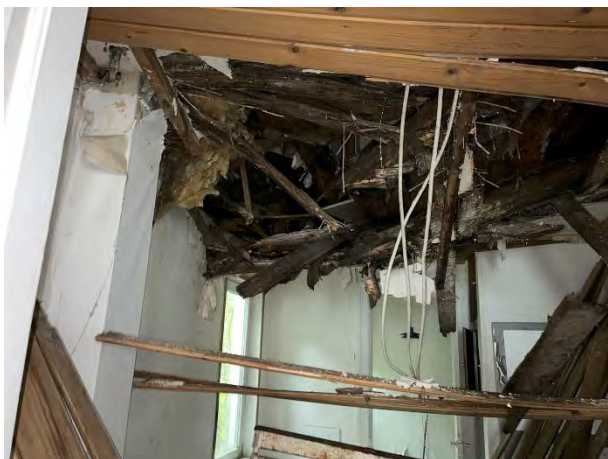
Sammenstyrtning i trapperum
