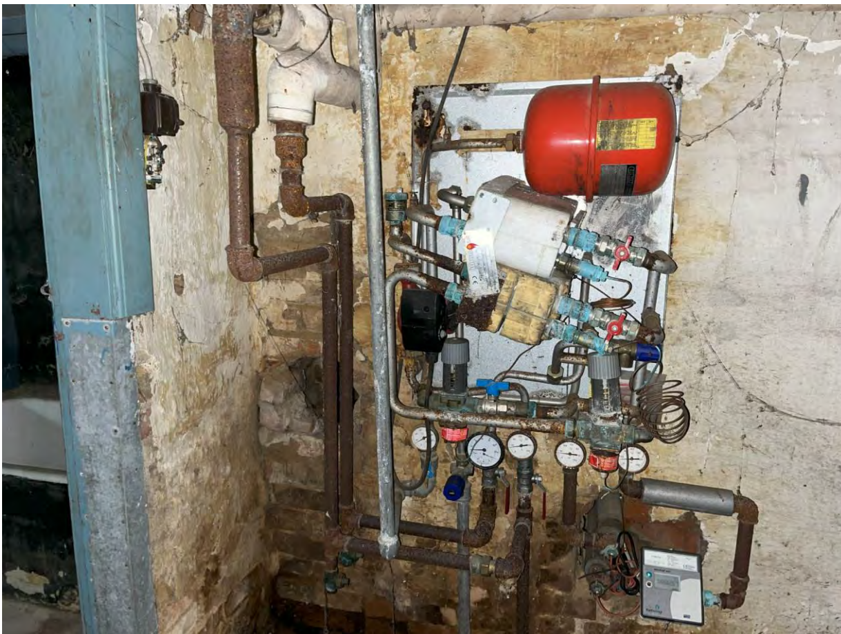
Varmeanlæg i kælder
