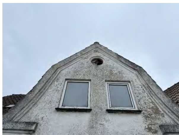
Glas i kvistvindue ikke intakt
