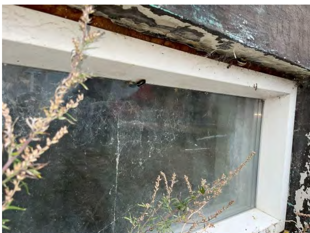
Manglende fuger ved kælder vindue
