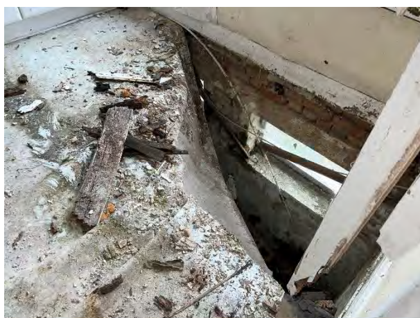
Sammenstyrtning af etageadskille i køkken
