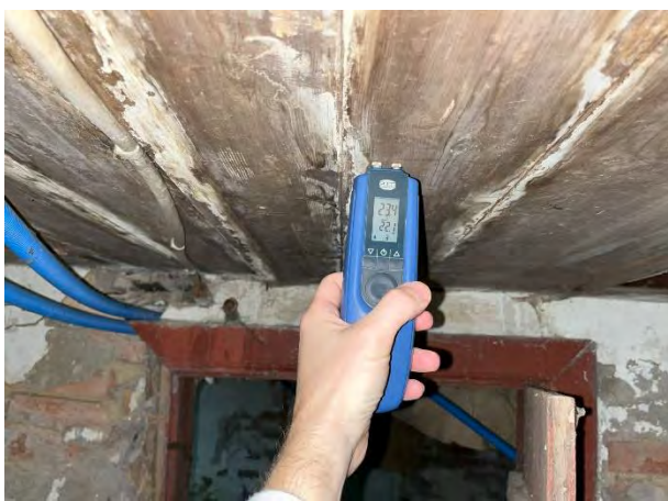
Skimmelbegroninger på loft/gulvbrædder og fugtmåling i kælder
