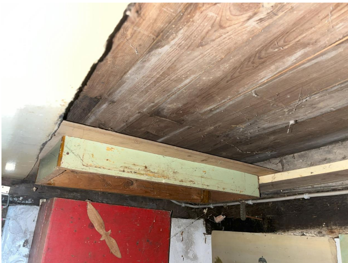
Skimmelbegroning på underside af gulvbrædder, kælder
