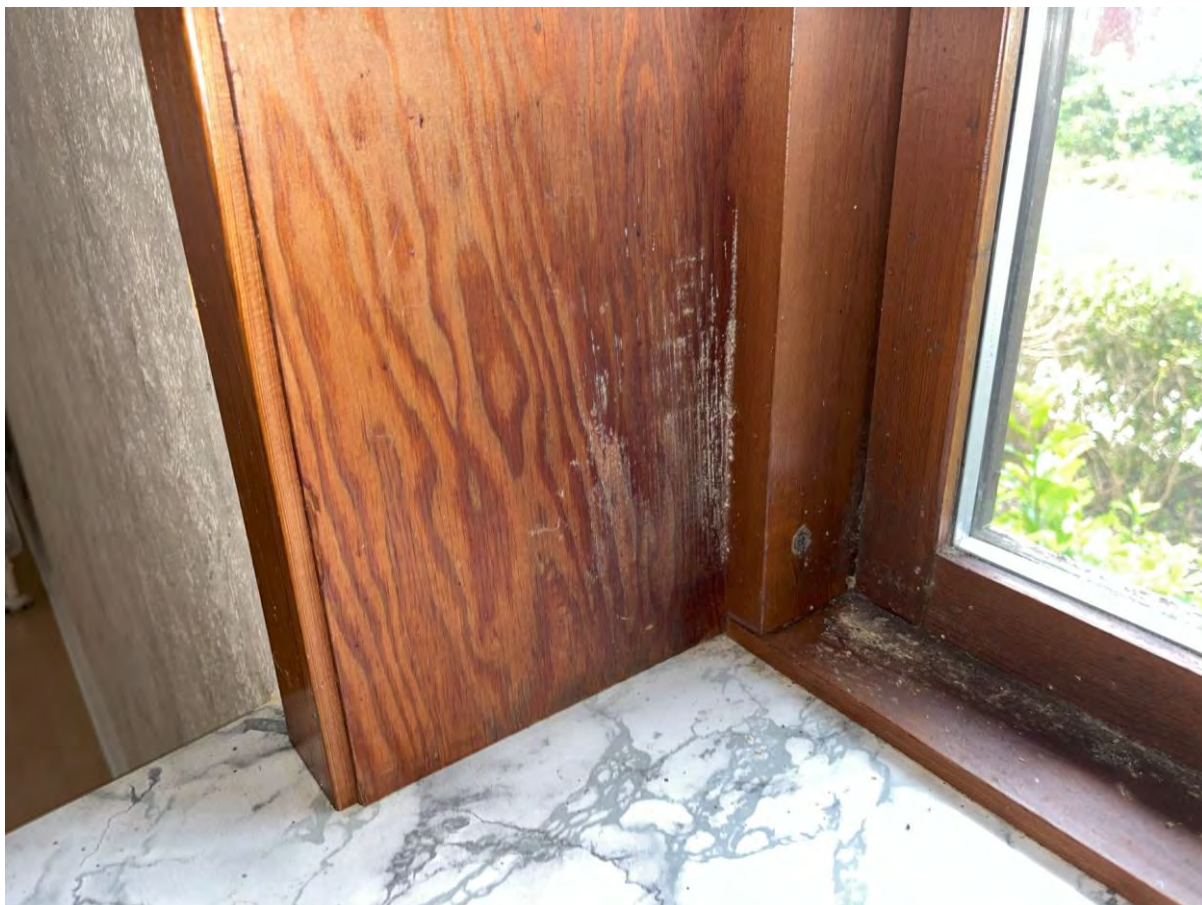
Misfarvninger på vindueslysning, stue
