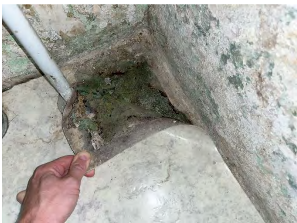
Udbredte skimmelbegroninger under gulvlinoleum, kælder
