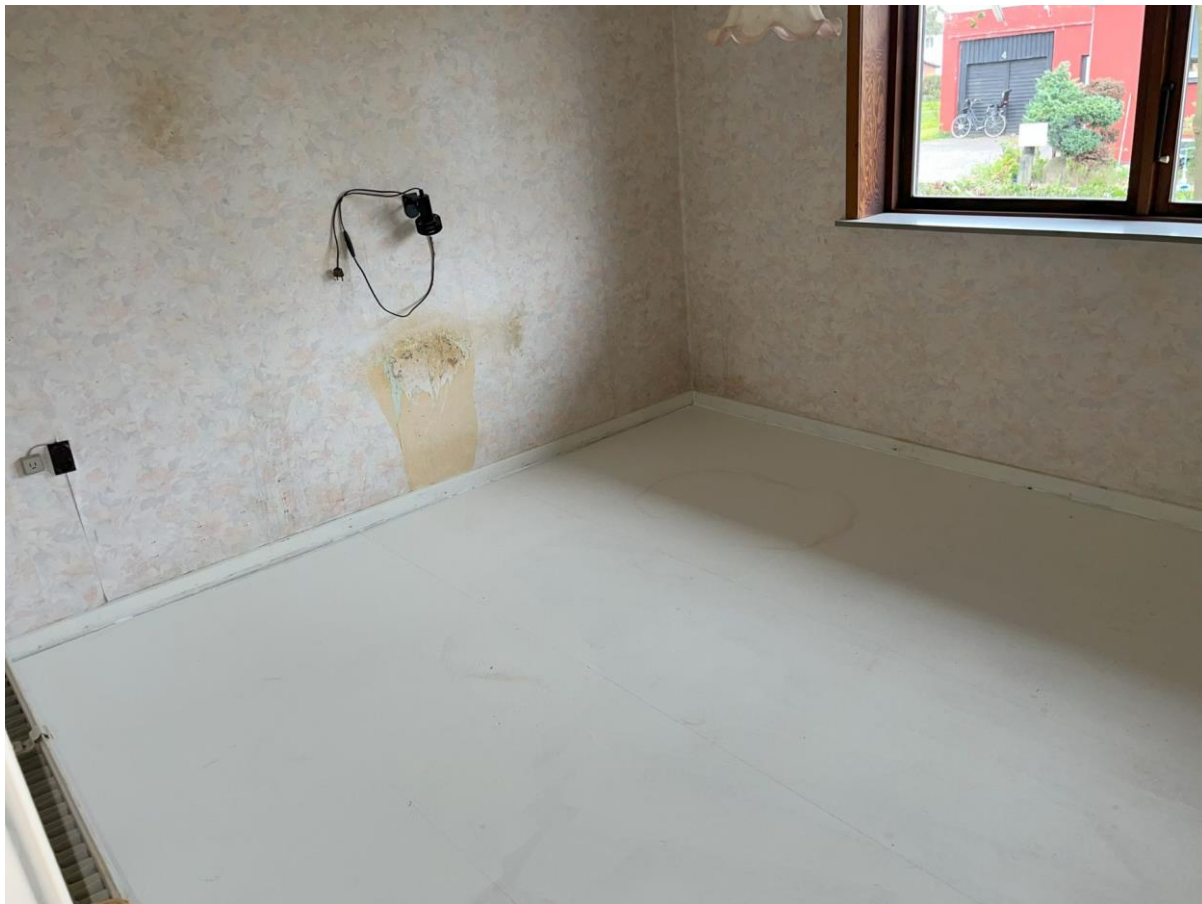
Misfarvninger i skillevægshjørne, soveværelse
