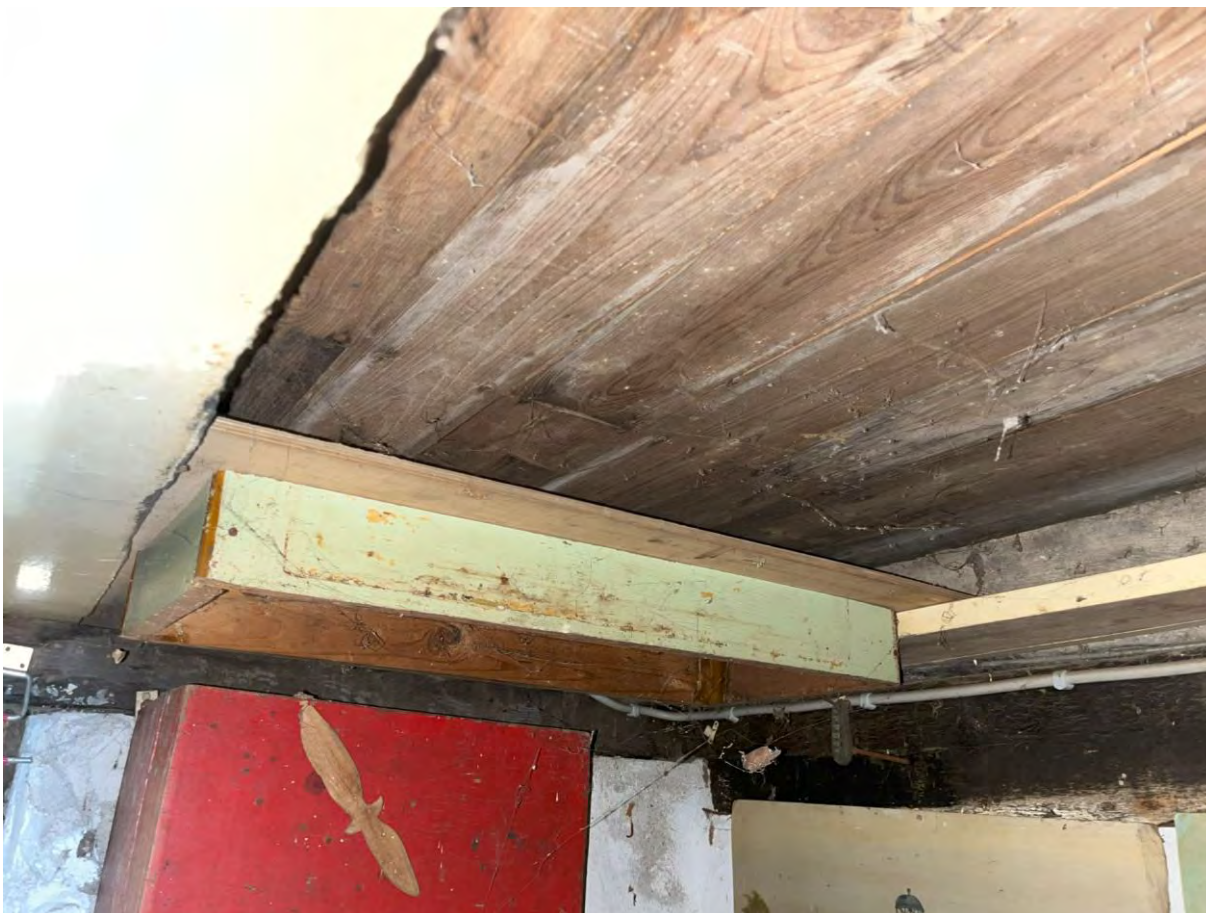
Skimmelbegroning på underside af gulvbrædder, kælder
