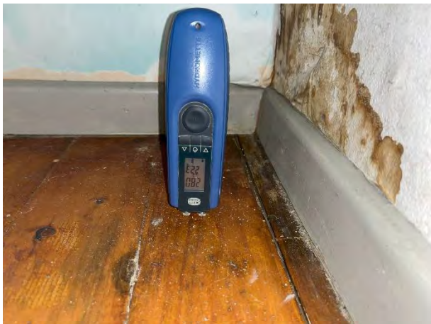
Fugtmåling af gulvbrædder, kælder
