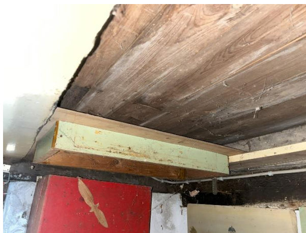
Skimmelbegroninger på underside af gulvbrædder, kælder
