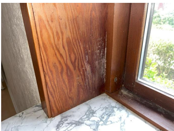
Misfarvninger på vindueslysning, stue
