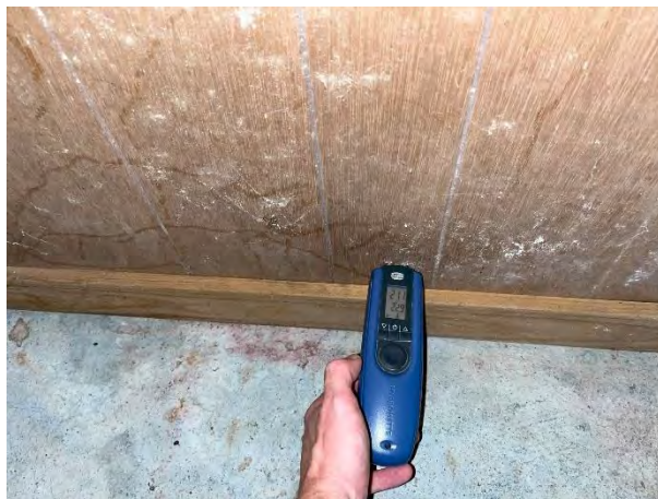
Fugtmåling af vægpanel, og skimmelbegroninger, kælder
