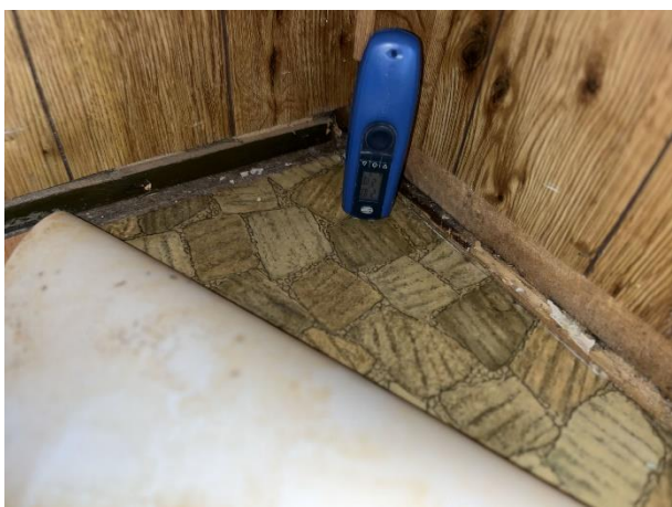
Fugtmåling af gulv, og misfarvninger under linoleum, ved prøvested i skillevægshjørne, køkken
