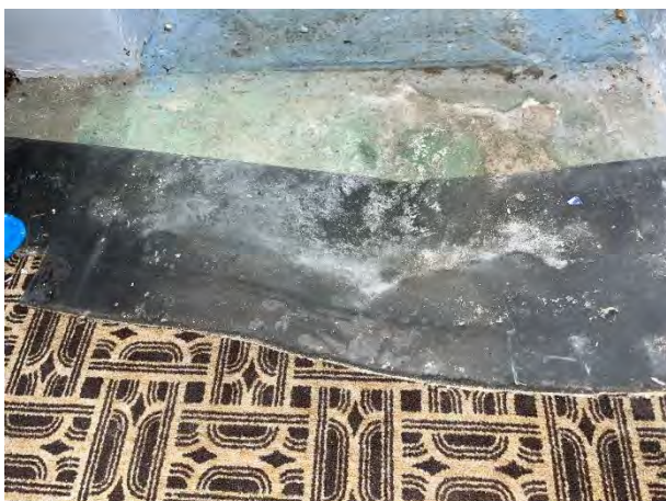
Skimmelbegroninger under gulvtæppe, kælder
