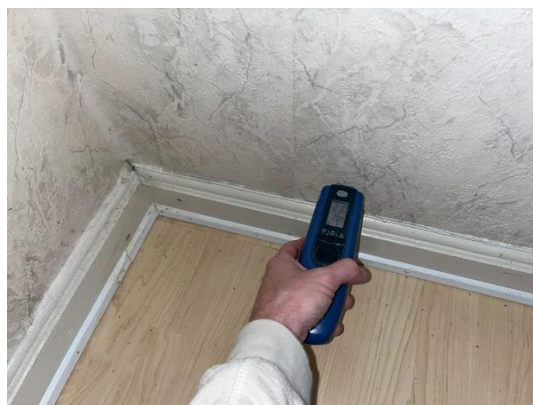
Fugtmåling af forsatsvæg på gavl, stue
