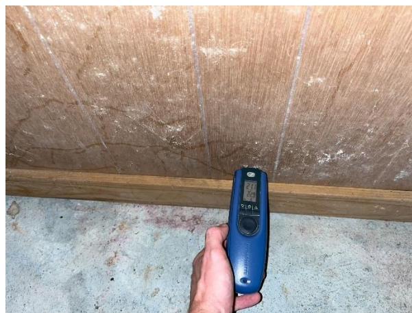
Fugtmåling af vægpanel, og skimmelbegroinger, kælder
