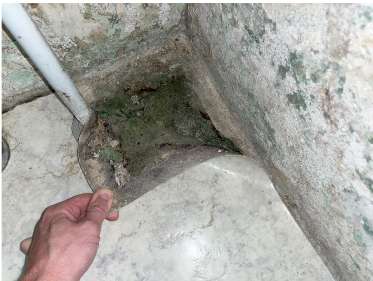
Udbredte skimmelbegroninger under gulvlinoleum, kælder
