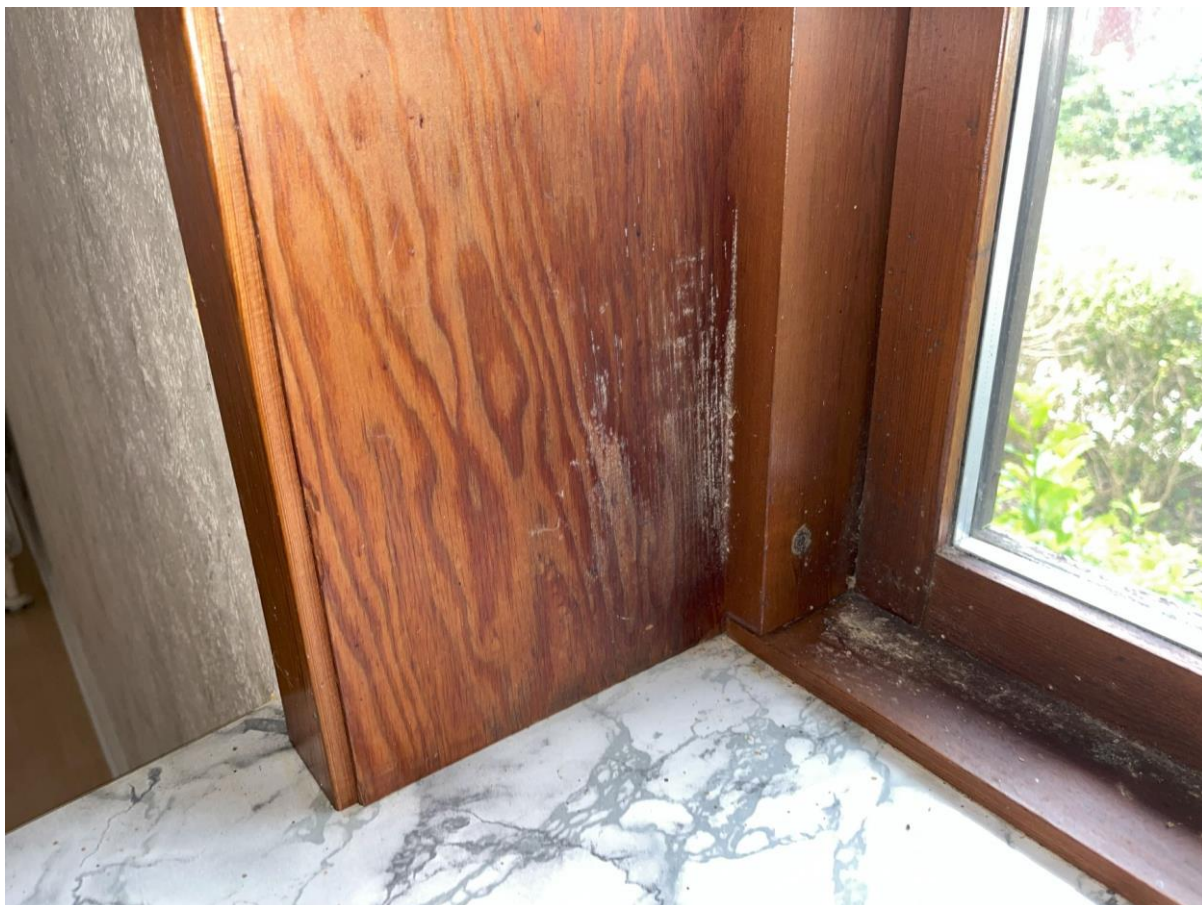
Misfarvninger på vindueslysning, stue
