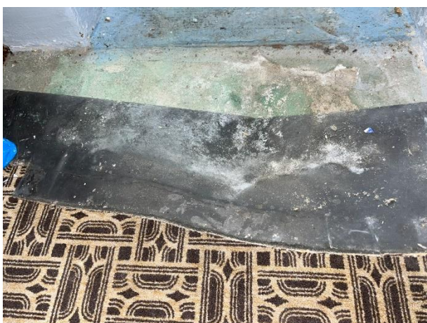
Skimmelbegroinger under gulvtæppe, kælder
