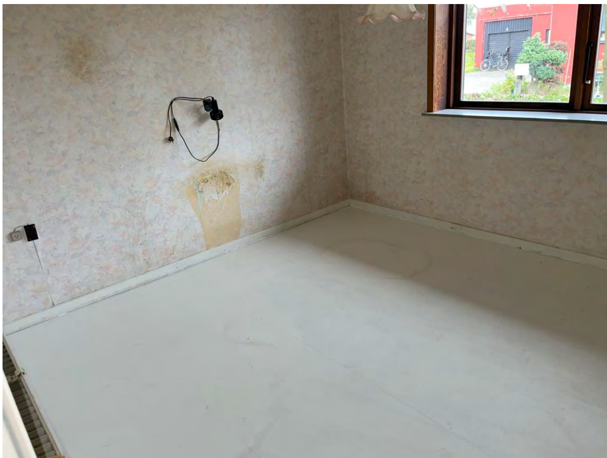
Misfarvninger i skillevægshjørne, soveværelse
