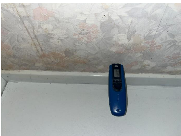
Fugtmåling af forsatsvæg på ydervæg, soveværelse
