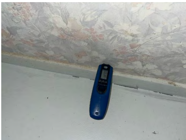
Fugtmåling af forsatsvæg på gavl, soveværelse
