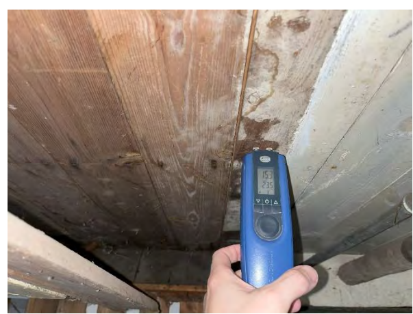
Fugtmåling af loft/gulvbrædder, kælder
