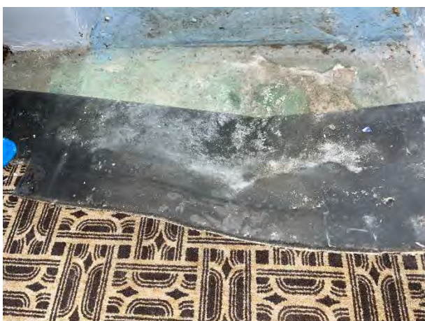
Skimmelbegroinger under gulvtæppe, kælder
