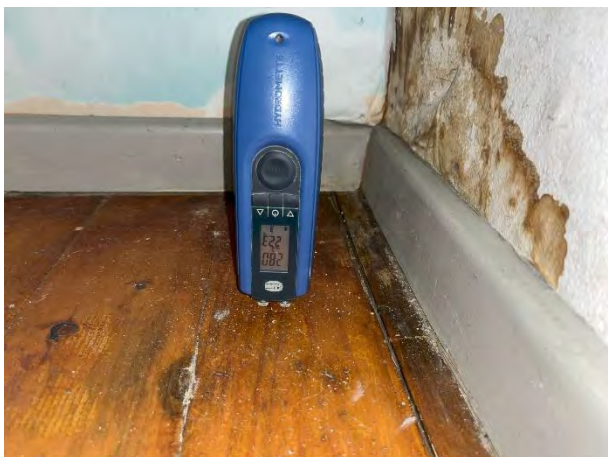
Fugtmåling af gulvbrædder, kælder
