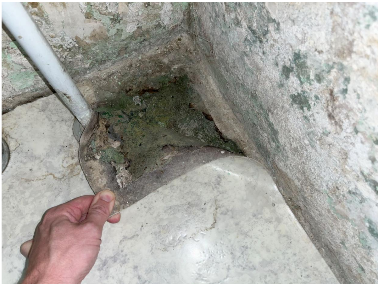
Udbredte skimmelbegroninger under gulvlinoleum, kælder
