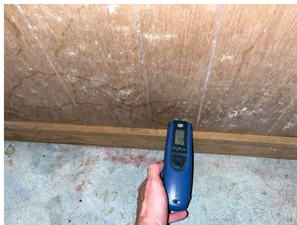
Fugtmåling af vægpanel, og skimmelbegroinger, kælder
