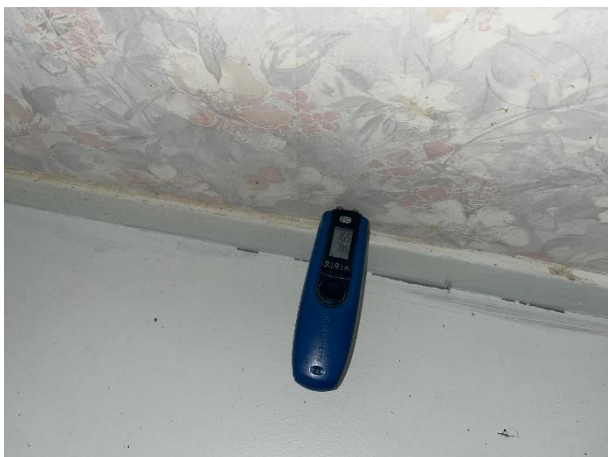
Fugtmåling af forsatsvæg på gavl, soveværelse
