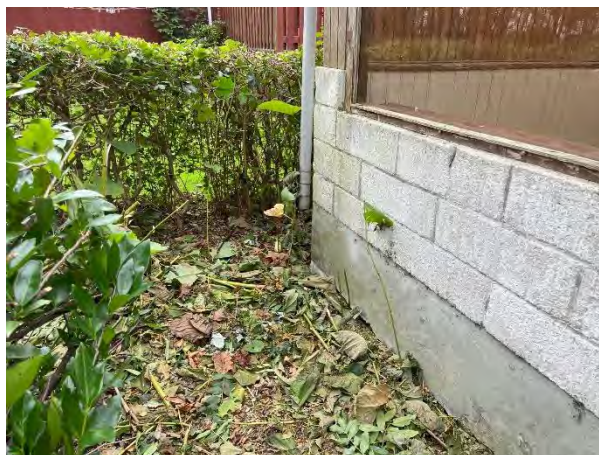
Tagvand ledes ned på terræn
