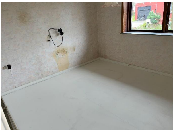
Misfarvninger i skillevægshjørne, soveværelse
