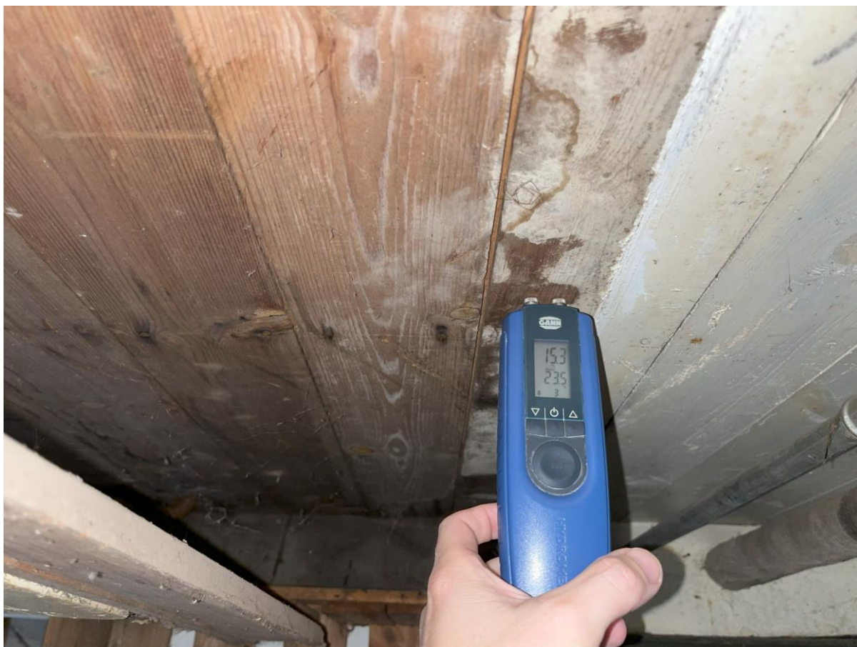
Fugtmåling af loft/gulvbrædder, kælder
