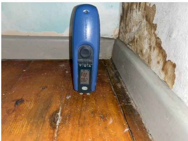
Fugtmåling af gulvbrædder, kælder
