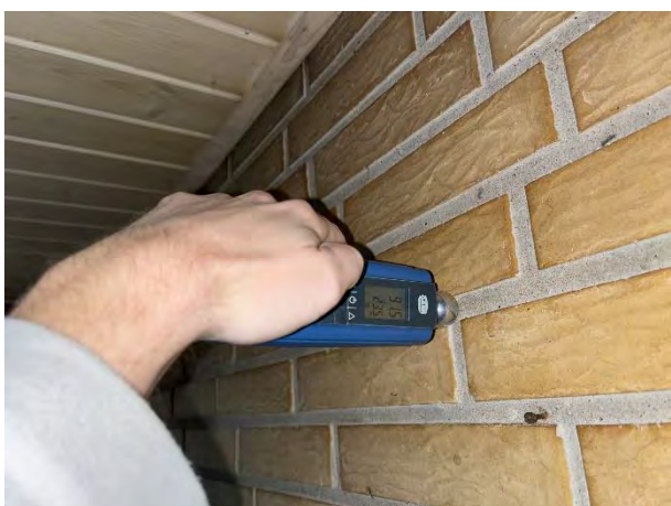
Fugtmåling af gavlvæg, køkken
