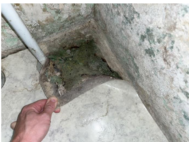
Udbredte skimmelbegroninger under gulvlinoleum, kælder
