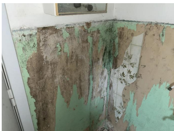
Udbredte skimmelbegroninger på vægge i badeværelse, kælder
