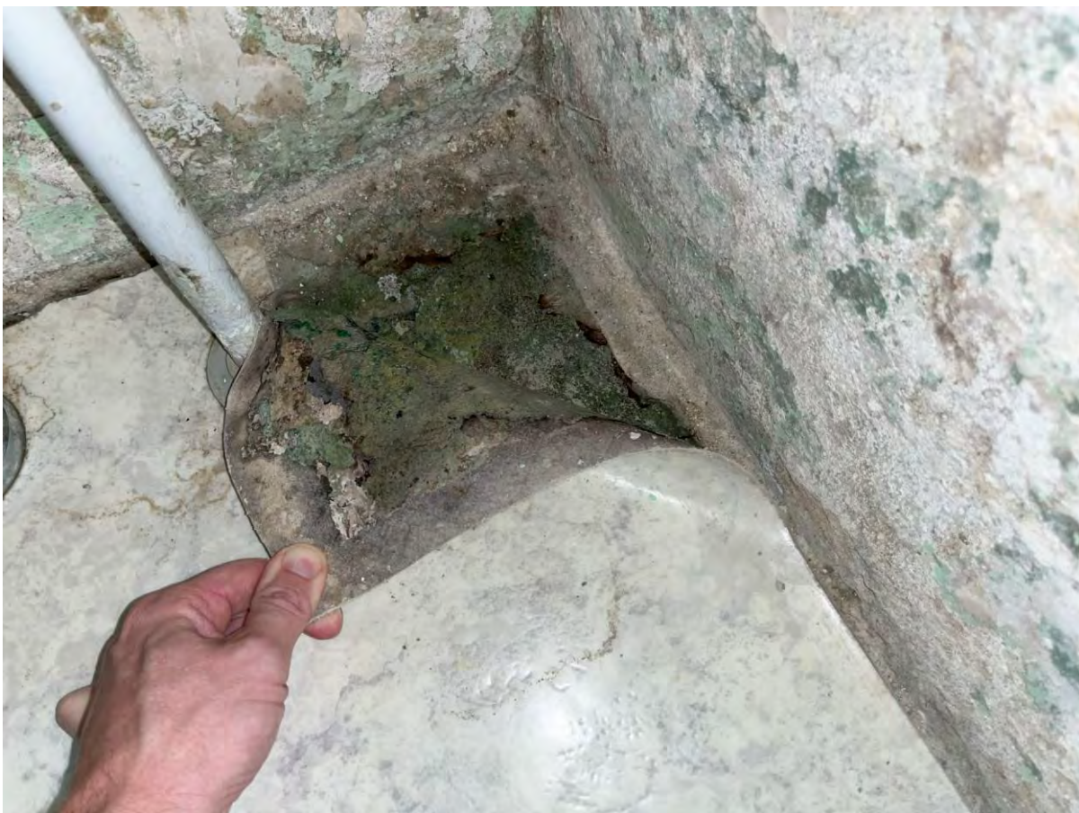
Udbredte skimmelbegroninger under gulvlinoleum, kælder
