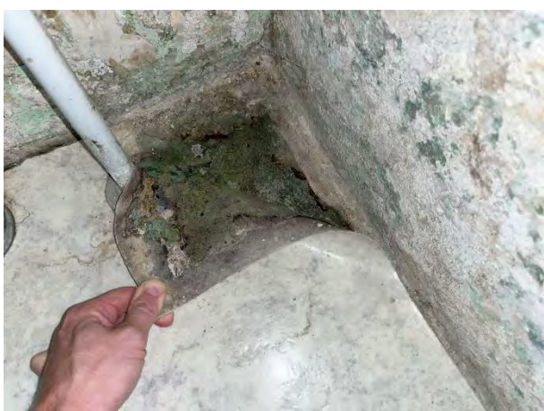
Udbredte skimmelbegroinger under gulvlinoleum, kælder
