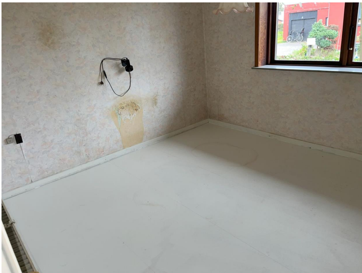
Misfarvninger i skillevægshjørne, soveværelse
