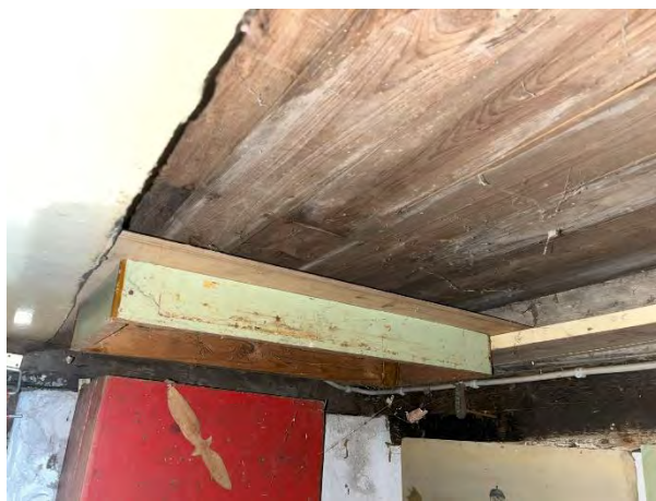
Skimmelbegroninger på underside af gulvbrædder, kælder
