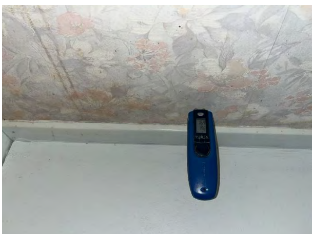
Fugtmåling af forsatsvæg på ydervæg, soveværelse
