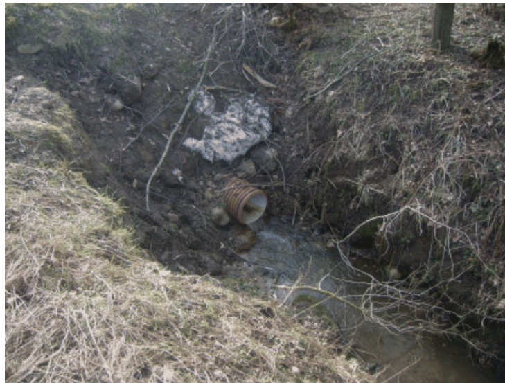
Udløb fra rørbrø, hvor det ses, at der er frit fald.
