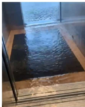
Figur 1 Elevatorskakt ved oversvømmelse i 2024
