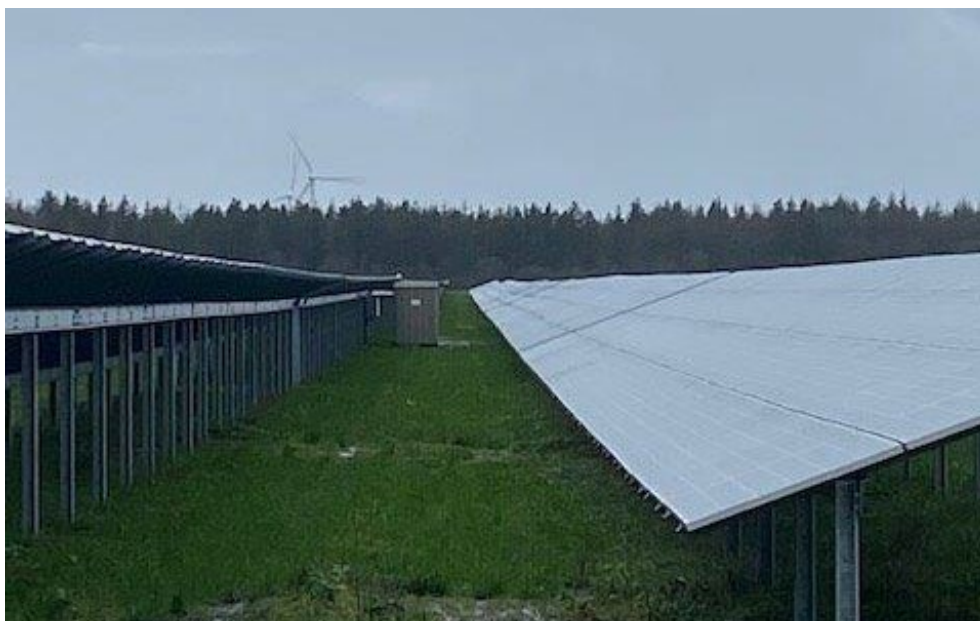
Foto med eksempel på solcellepaneler og en distributionstransformer, der er indpasset bag panelerne.
