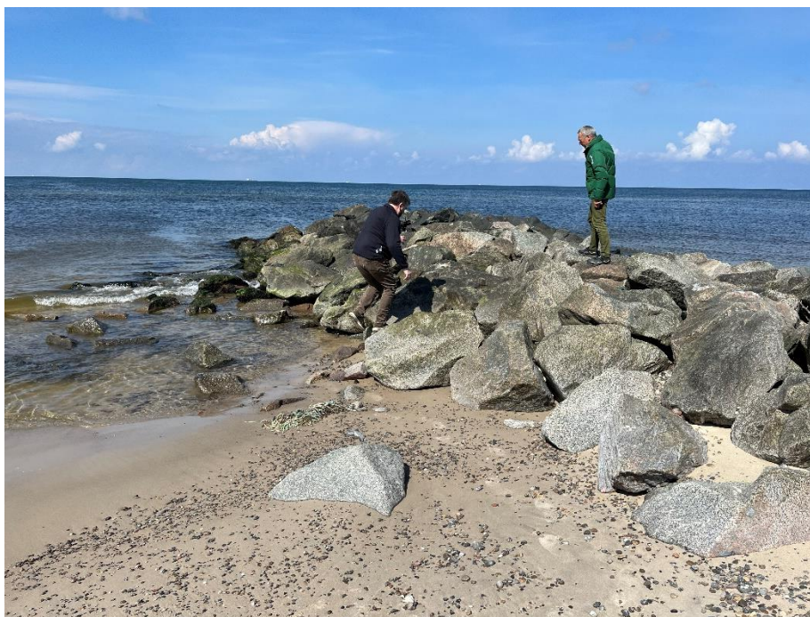
Figur 5: Høfde 11/78, Dæksten fra høfdehoved omplaceret og aflejret i området omkring høfden, rundt langs hele høfdehovedet.
