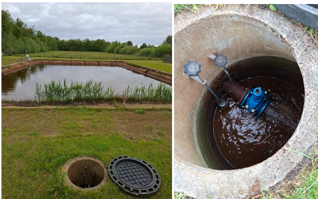
Figur 13: Prøvetagning i brønd ved udløb fra returskyllevandsbassin.
