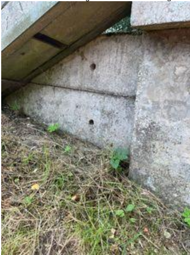
Figur 3-8 Mindre huller i betonen.
