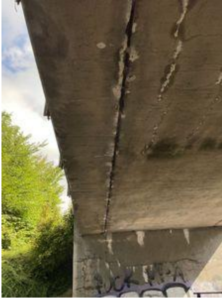
Figur 3-29 Smal sprækker mellem betondelene i broen, de er smalle og overfladiske, ikke egnede for flagermus.
