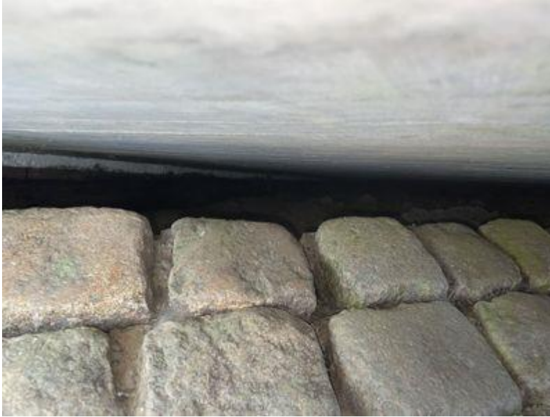
Figur 3-39 Hulrum mellem brosten og bropladen, dyb og smal revne med en højde på 10-15 cm på de højeste steder og op til 2 meter dybt. Det vurderes at revnen er for åben og jordnær hvilket giver adgang for rovdyr.
