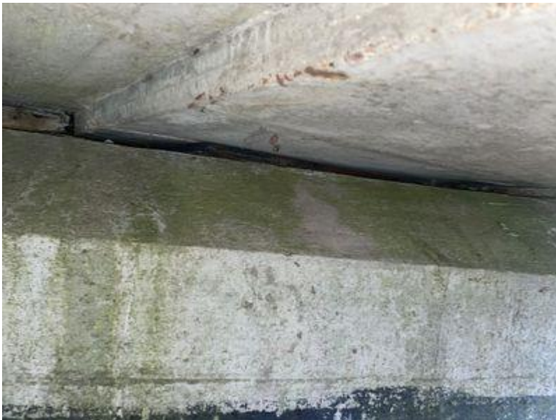
Figur 3-14 Overfladisk sprække mellem bro og jernbanedige.
