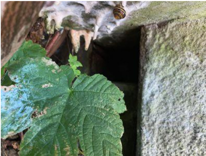
Figur 3-30 Hul bag beton ud mod banediget.
