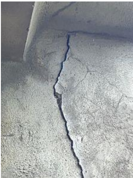
Figur 3-18 Revnet cement i siden af broen.
