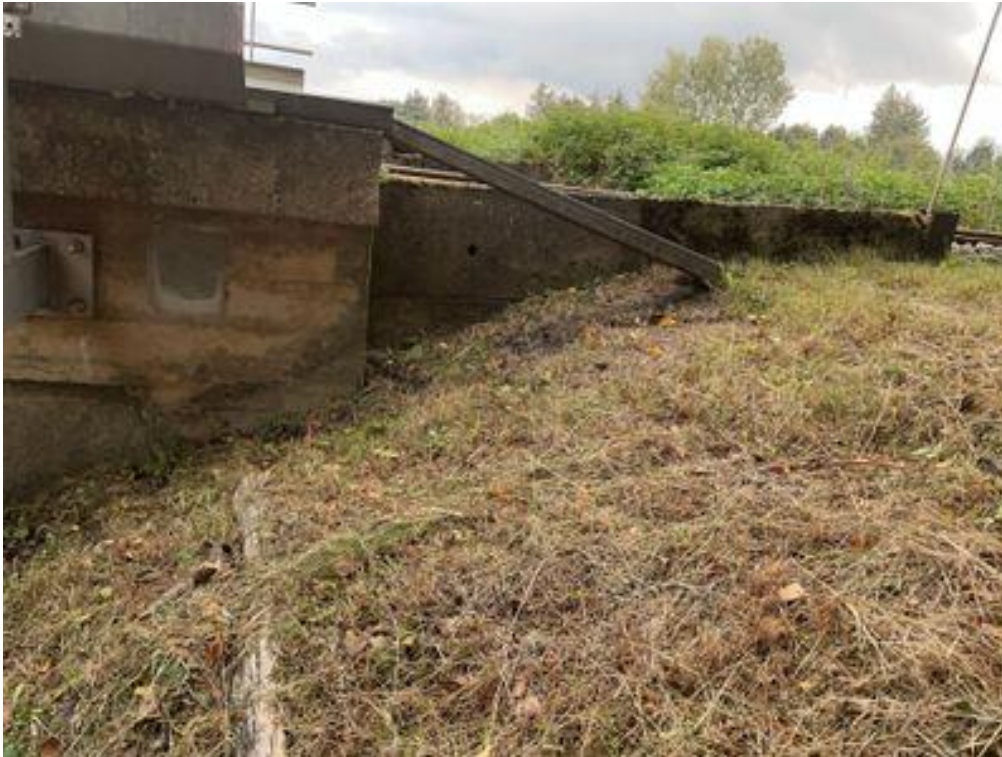
Figur 3-9 Mindre huller i betonen.
