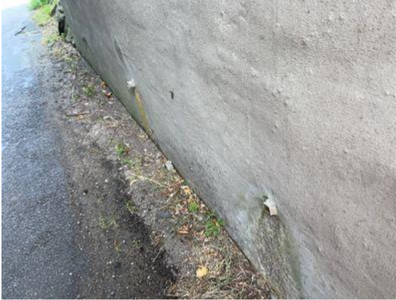
Figur 3-11 Små drænhuller hvor der er rindende vand.
