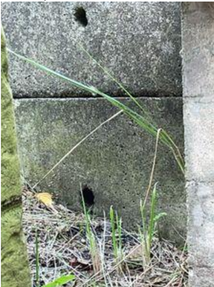
Figur 3-10 Mindre huller i betonen.
