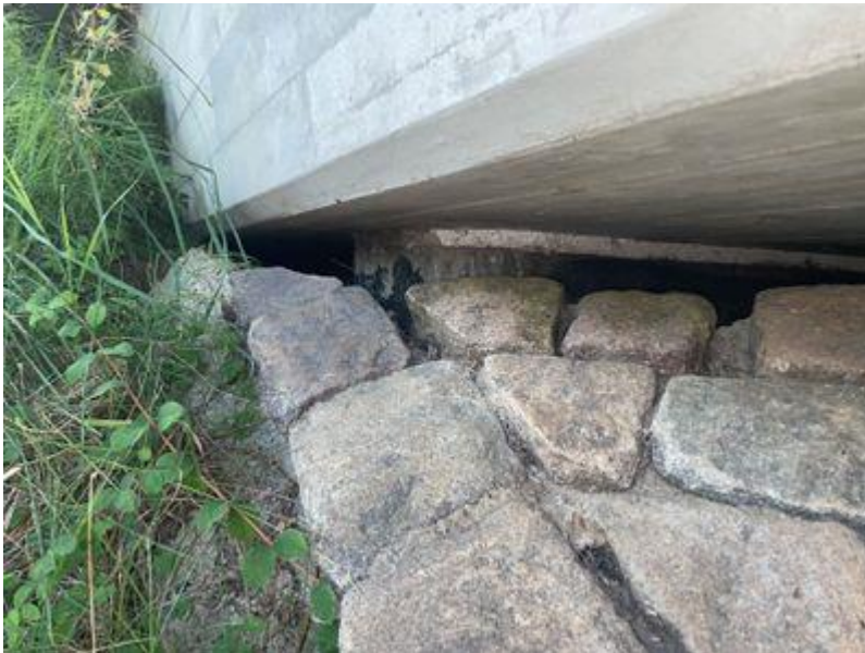
Figur 3-40 Lille hul i kanten af broen. Det vurderes at det er for jordnært og åbent hvilket giver adgang for rovdyr.
