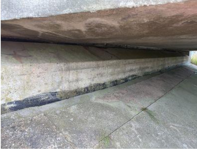
Figur 3-13 Overfladisk sprække mellem bro og jernbanedige
