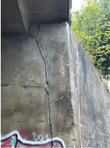
Figur 3-17 Lang overfladisk revne i betonen, uegnet for flagermus.
