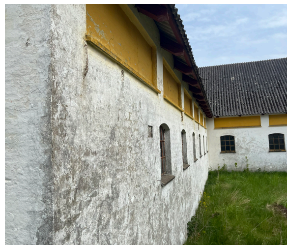
Dato: 11-05-2026 Type: Facade mod syd Stikord: Sild i murværk
